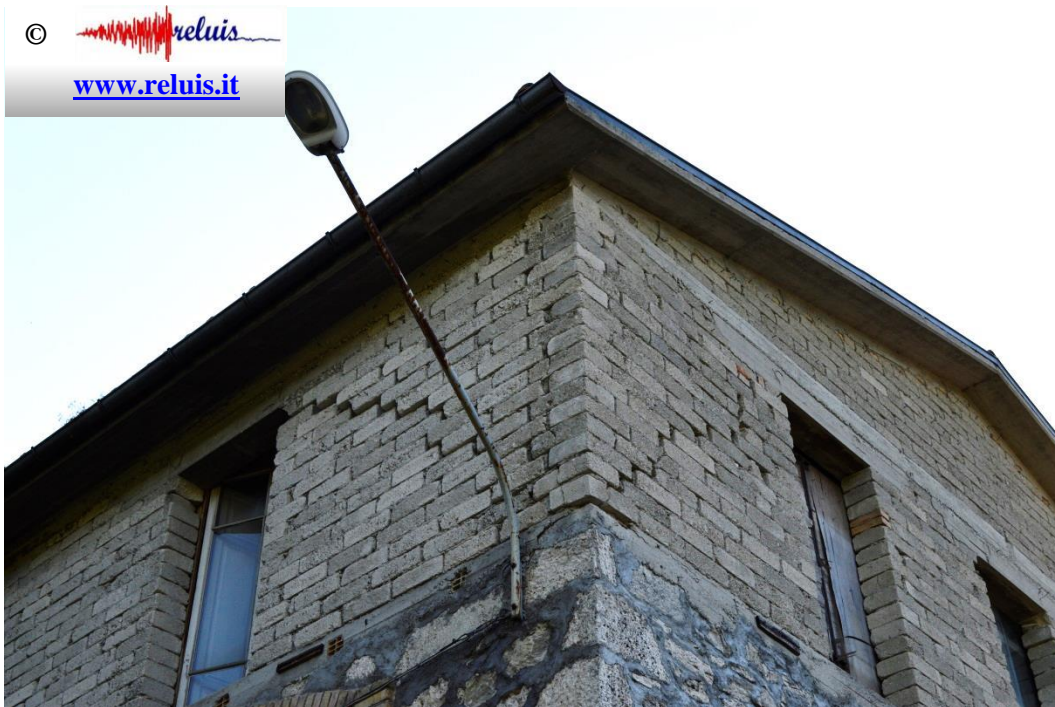
Edificio in muratura - Accumoli Crisi a taglio-trazione della parete, con innesco del collasso del cantonale.
