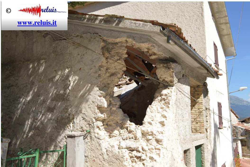
Edificio in muratura - San Giovanni (frazione di Accumoli) Dettaglio della crisi del cantonale e perdita di appoggio del tetto in c.a.
