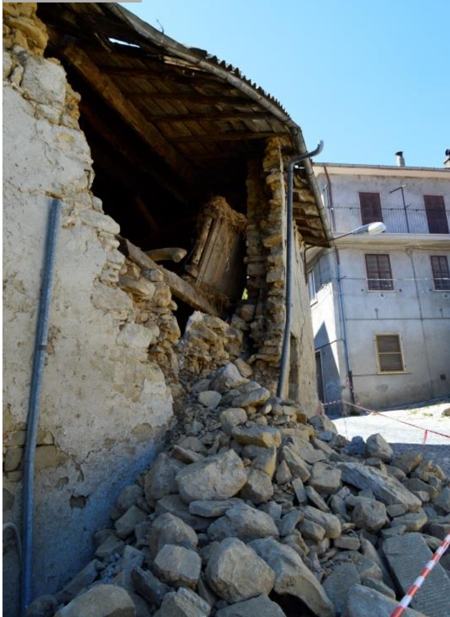
Edificio in muratura - Scai (frazione di Amatrice) Evidenza di meccanismo fuori piano di parete a doppio paramento.
