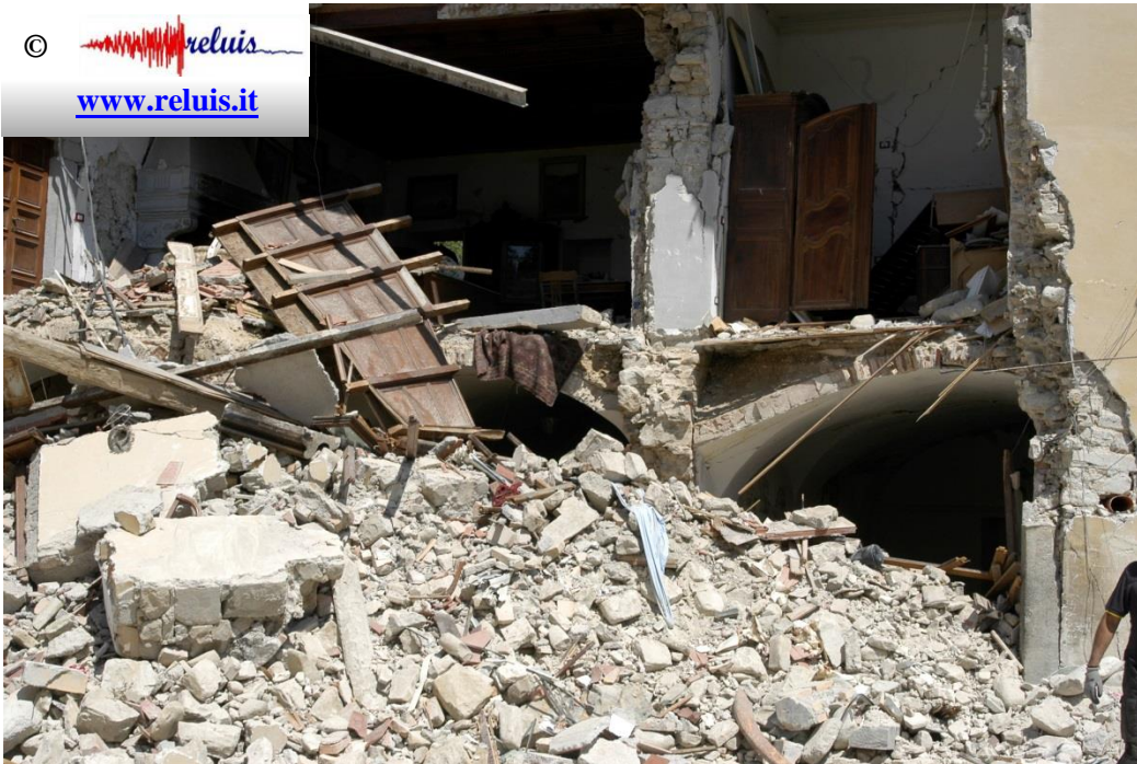
Edificio in muratura - Amatrice Collasso di pareti, pilastri e volte in muratura.
