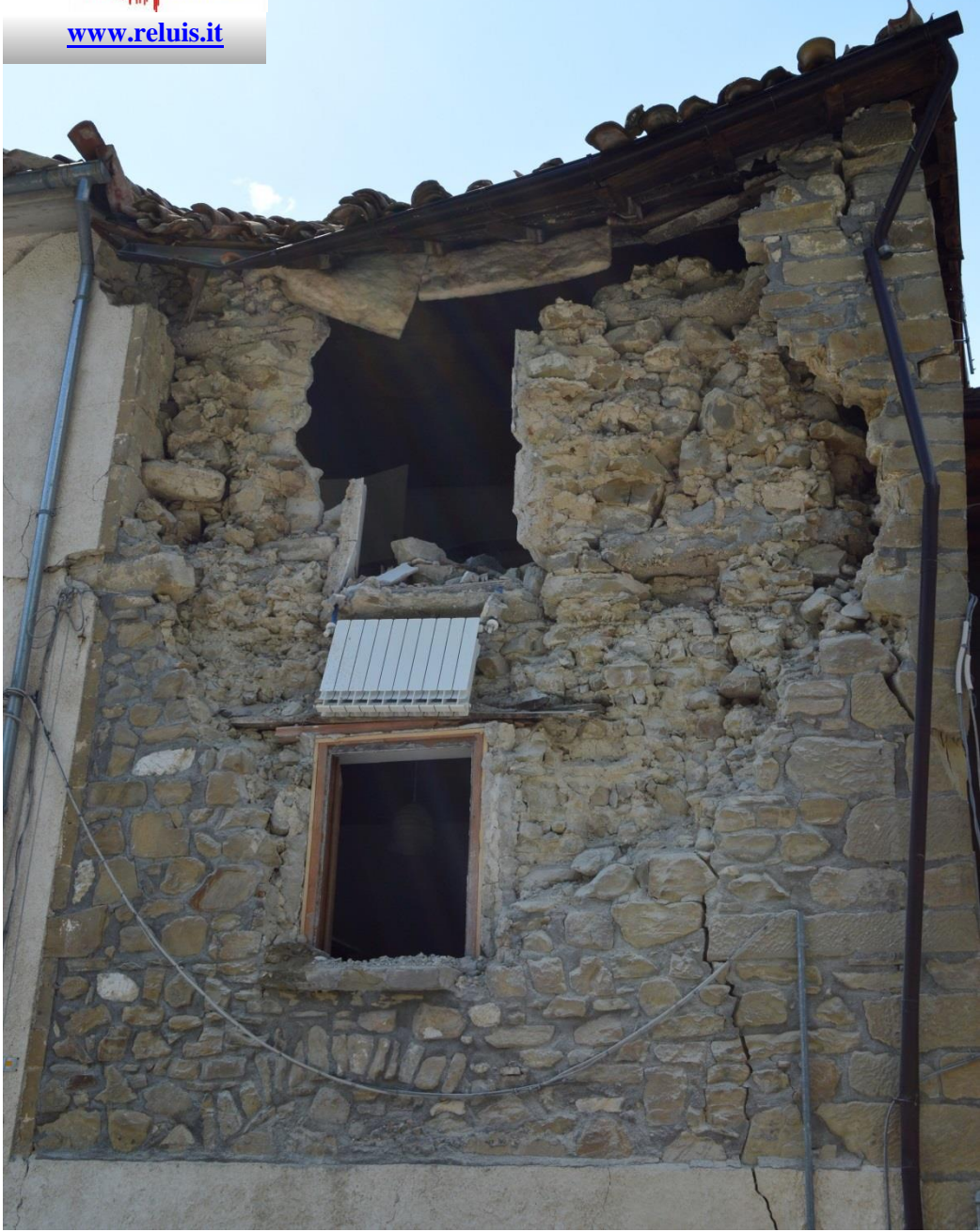
Edificio in muratura – Pescara del Tronto (frazione di Arquata del Tronto) Evidenza di crollo del paramento esterno della muratura a doppio paramento.
