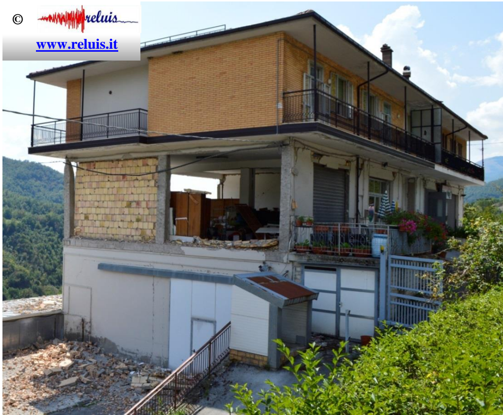
Edificio in c.a. – Pescara del Tronto (frazione di Arquata del Tronto)
