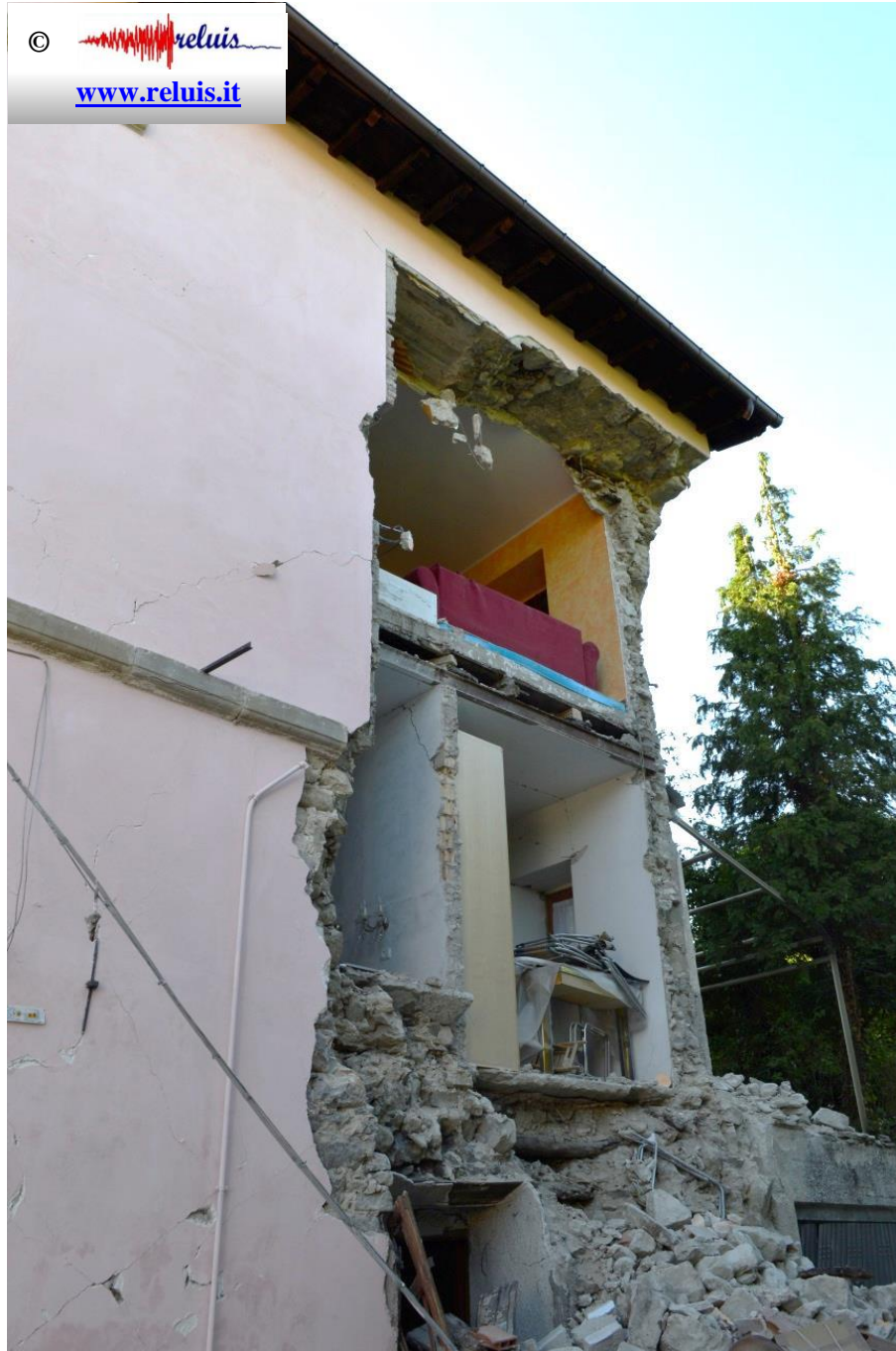
Edificio in muratura - Accumoli Meccanismo di crisi per disgregazione e ribaltamento fuori piano.
