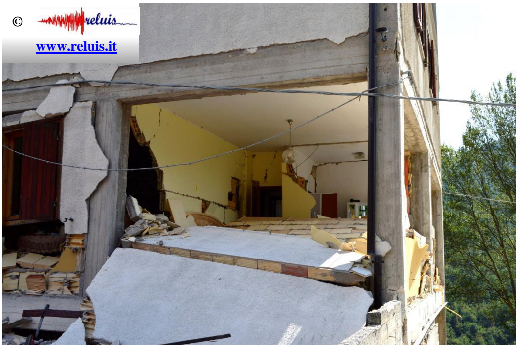
Edificio in c.a. – Pescara del Tronto (frazione di Arquata del Tronto) Dettaglio del meccanismo di ribaltamento fuori piano della tamponatura.
