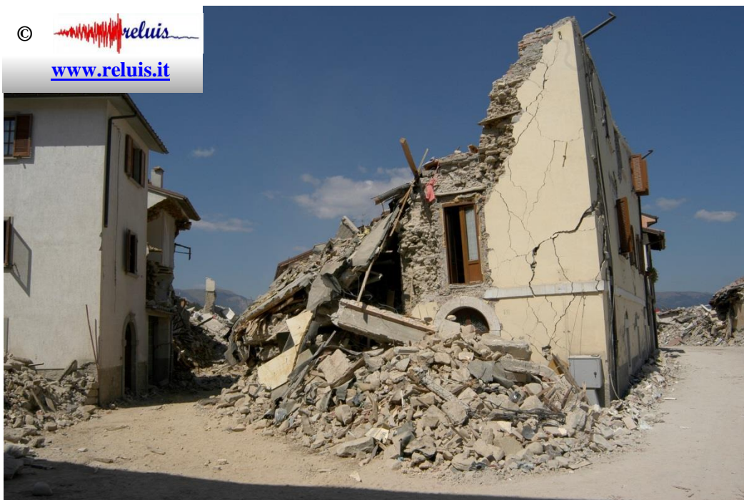
Edificio in muratura - Amatrice Crollo parziale dell'edificio.
