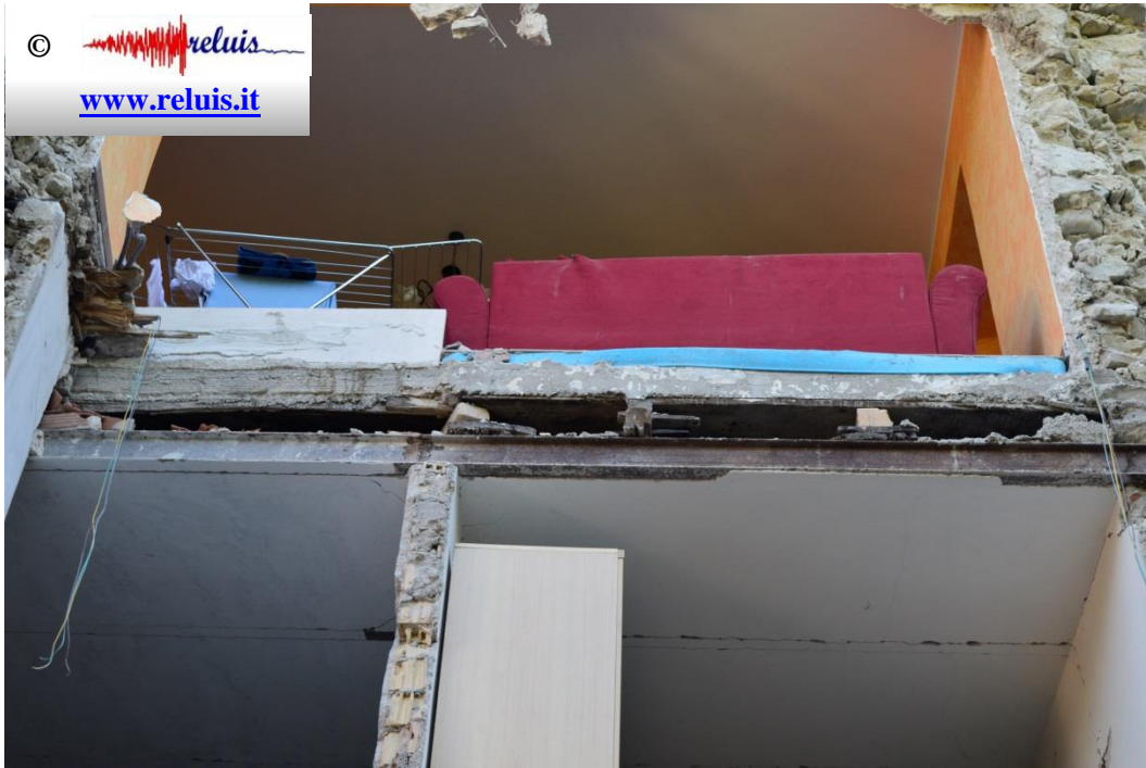
Edificio in muratura - Accumoli Particolare della crisi riportata nella foto precedente.
