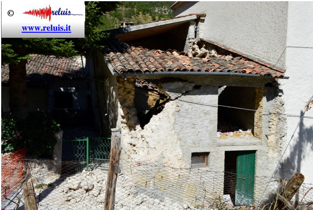
Edificio in muratura - San Giovanni (frazione di Accumoli) Crisi del cantonale e danni al tetto di copertura.
