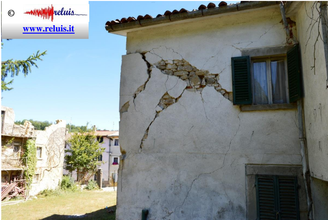
Edificio in muratura - Scai (frazione di Amatrice) Meccanismo di danneggiamento a taglio nel piano con espulsione del cantonale.
