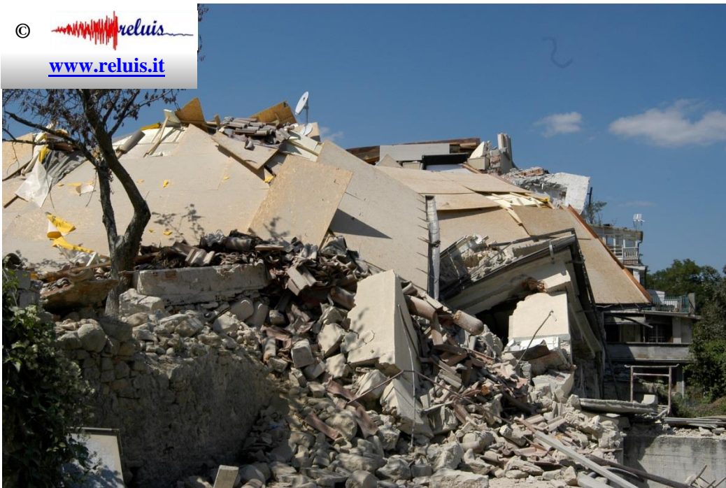
Edifici vari - Amatrice Collasso di una intera stecca di edifici.
