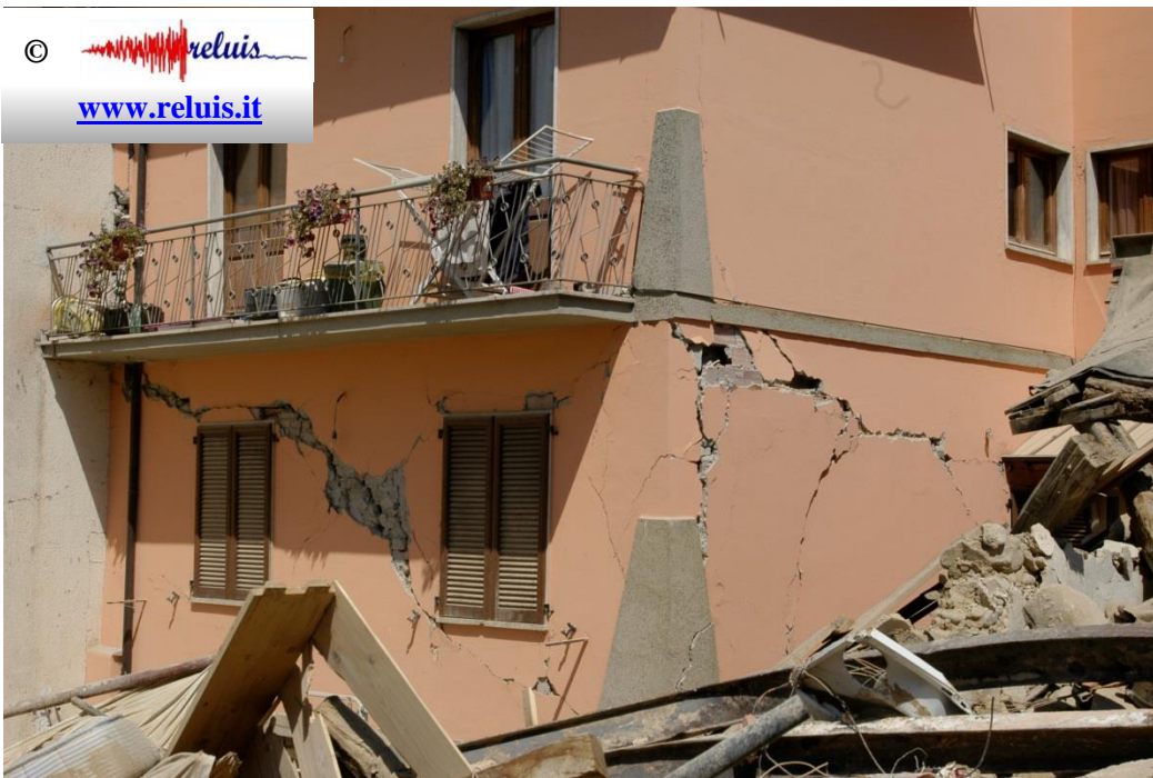
Edificio in muratura - Amatrice Evidenza di crisi combinata nel piano e crisi fuori piano di due pareti ortogonali.
