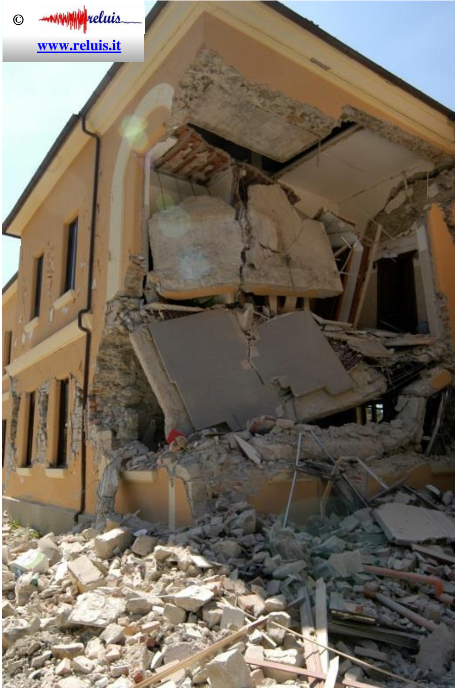
Edificio in muratura (scuola Romolo Capranica) - Amatrice Collasso delle pareti portanti e conseguente perdita di appoggio dei solai.
