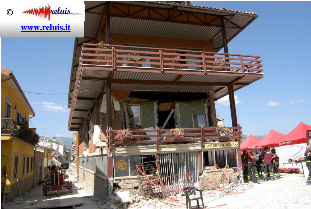
Edificio in acciaio - Amatrice Danneggiamento degli elementi di tamponatura.
