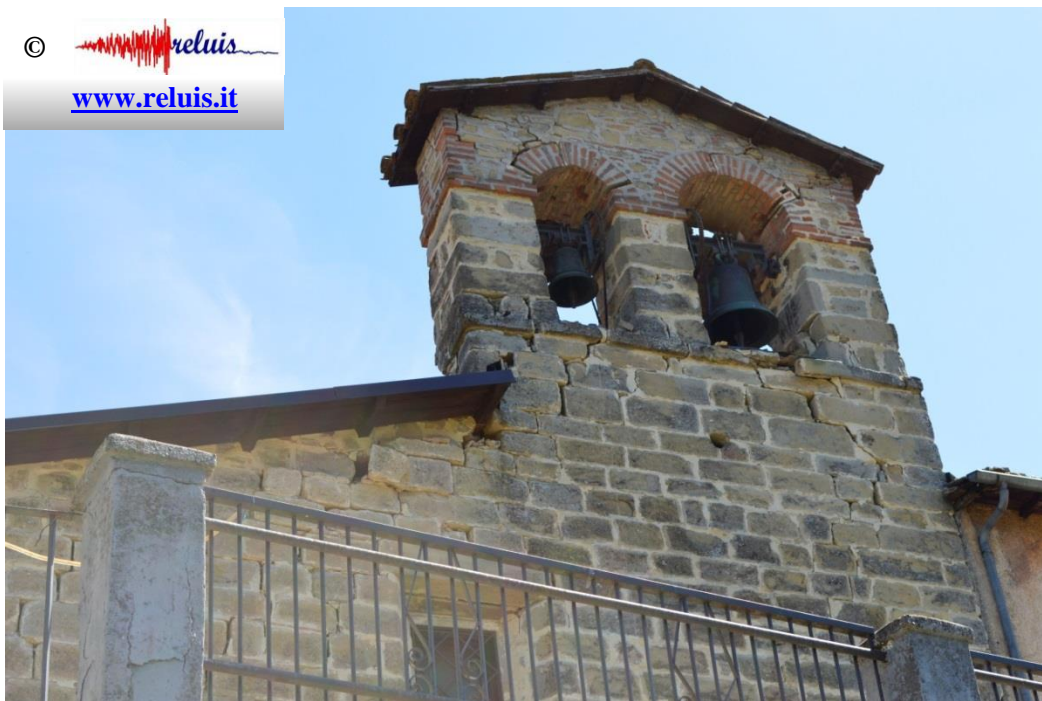
Chiesa in muratura - Scai (frazione di Amatrice)
