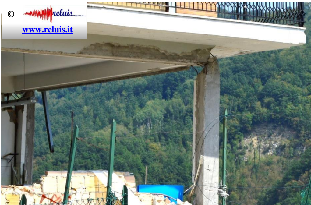
Edificio in c.a. – Pescara del Tronto (frazione di Arquata del Tronto)
