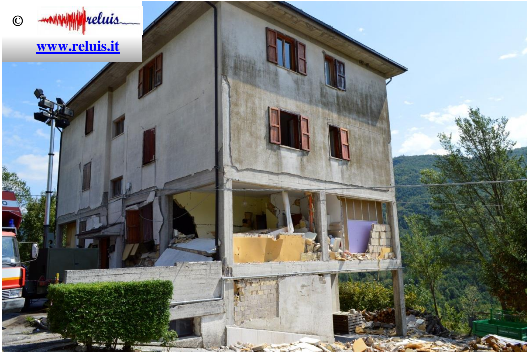
Edificio in c.a. – Pescara del Tronto (frazione di Arquata del Tronto) Meccanismo di ribaltamento fuori piano della tamponatura.
