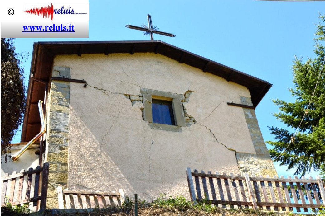
Chiesa in muratura - Scai (frazione di Amatrice)
