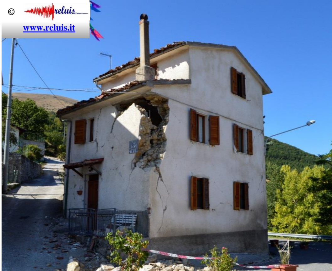
Edificio in muratura - Villanova (frazione di Accumoli) Meccanismo di crisi del cantonale.
